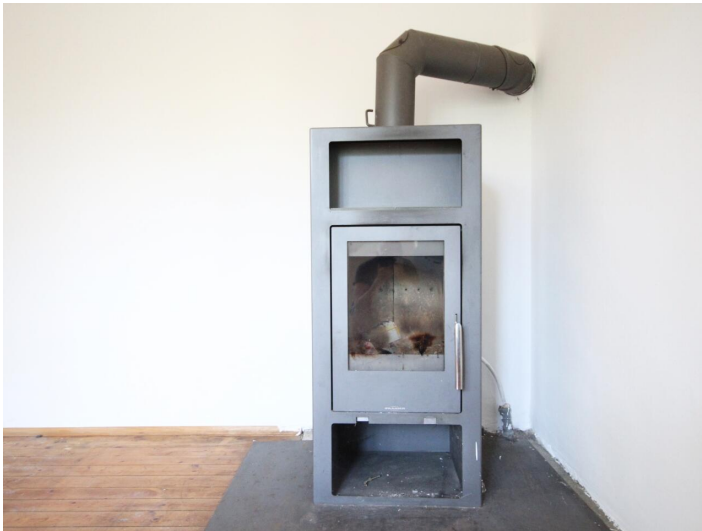
Heizung / Ofen im Erdgeschoss
