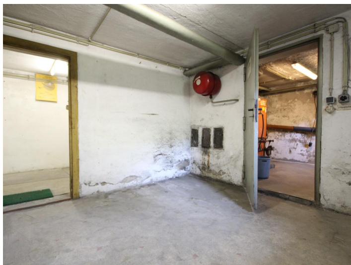
Wohnhaus/Sanierungsbedürftig in bester Lage
