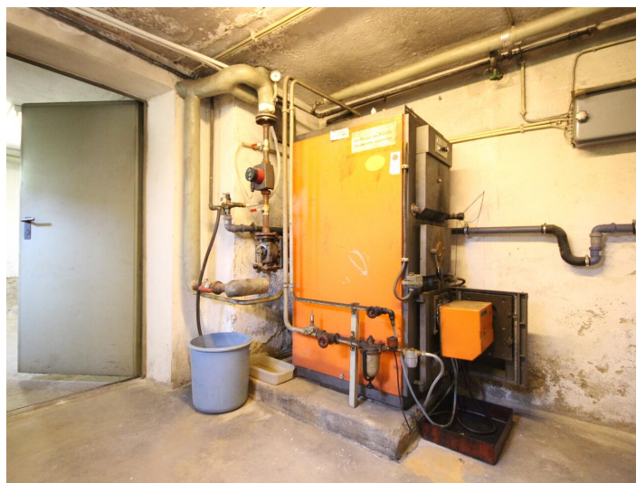
Wohnhaus/Sanierungsbedürftig in bester Lage
